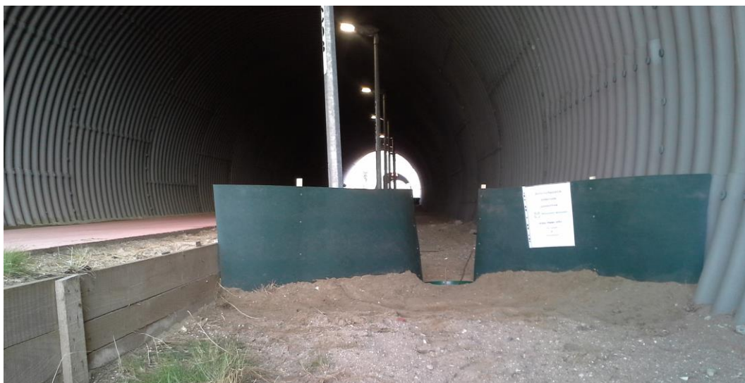
Figuur 104: Fuikvormige schermopstelling met ingegraven emmer in fiets-faunatunnel
